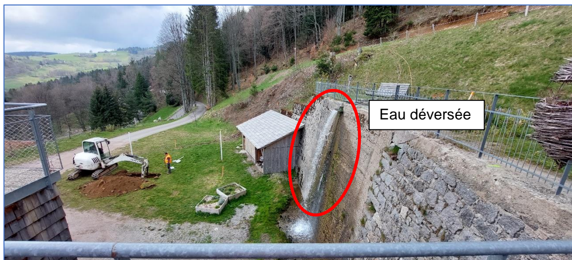
Photographie du site le 20/04/203 – vue depuis le haut du mur – déversement des eaux de coteaux le long du mur
